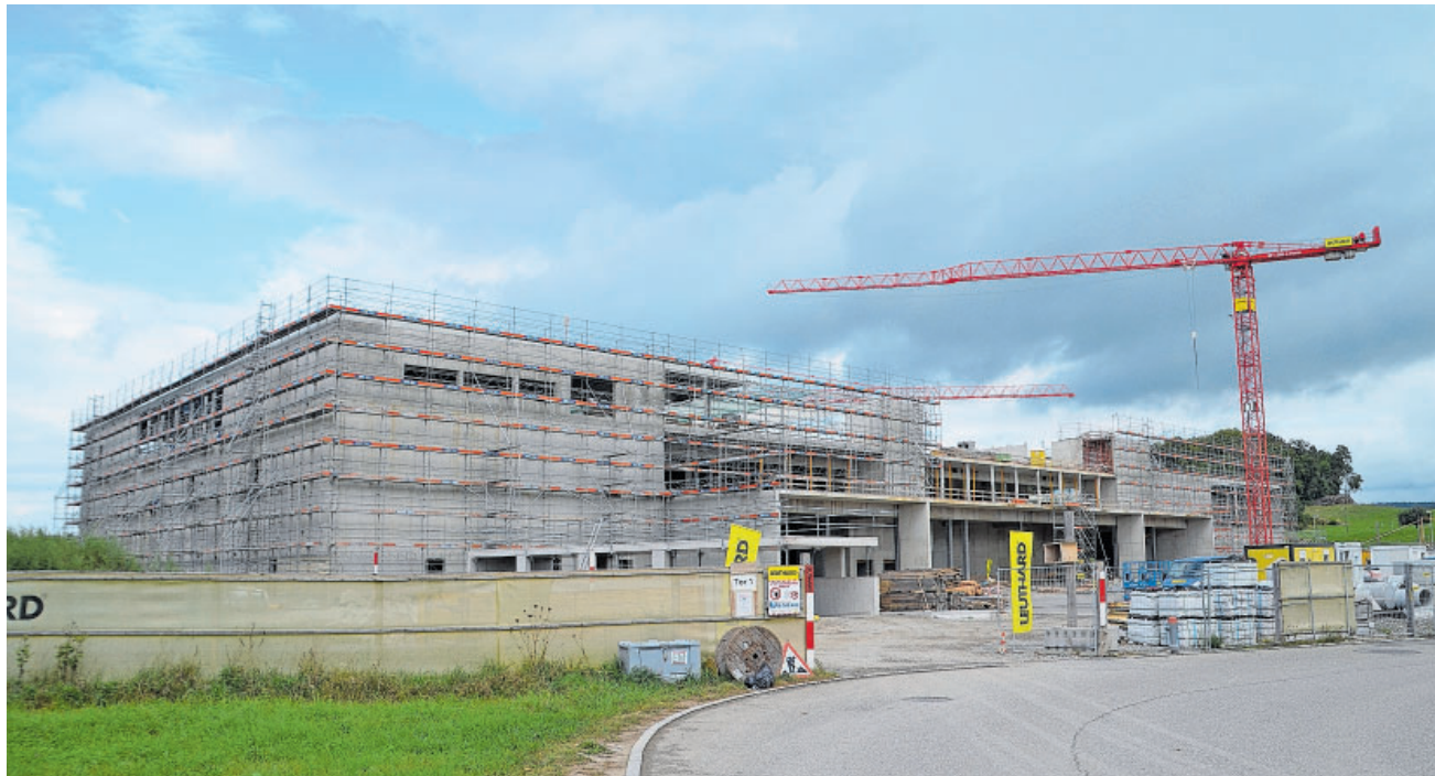
Grösste Baustelle in Affoltern: An der Moosbachstrasse entsteht ein Center für OBI und Möbel Pfister. (Bild Thomas Stöckli)
